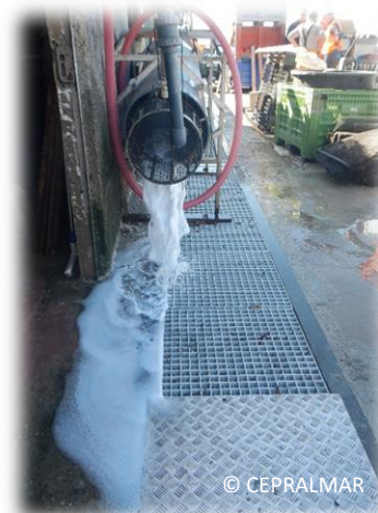
Décanteur (système canal)
